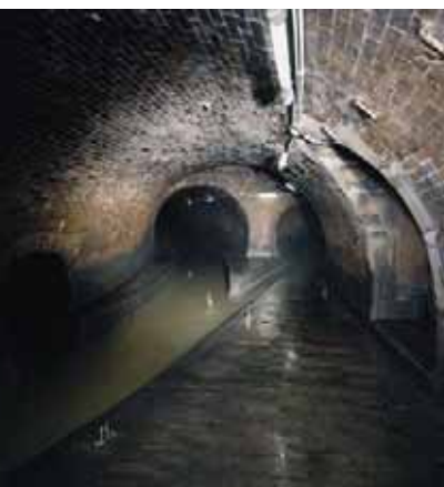
Berliner Abwasserkanal Berlin sewer
