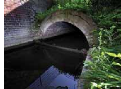
Mischwassereinleitung in ein Gewässer Combined water flow into surface waters
