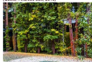
Wand-/Fassadenbegrünung, Institut für Physik, HUB (Quelle: Andreas Süß, 2018)
