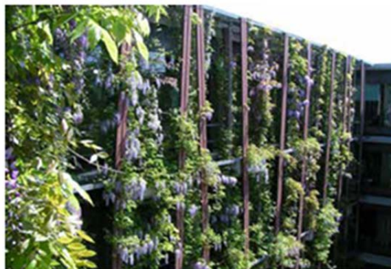
Systemgebundene Fassadenbegrünung in Kübeln, Insitut für Physik in Berlin Adlershof (Foto: M. Schmidt); Sonderform mit Anstaubewässerung und Kletterhilfe
