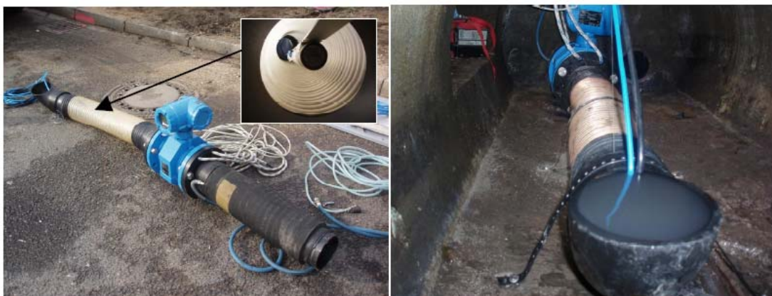
Abbildung 2.11: Parameter- und Durchflussmessung im Kanalnetz (temporäre Messstelle), aus Hoppe et al. (2008)
