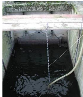
Entnahmestelle des Klarwassers
