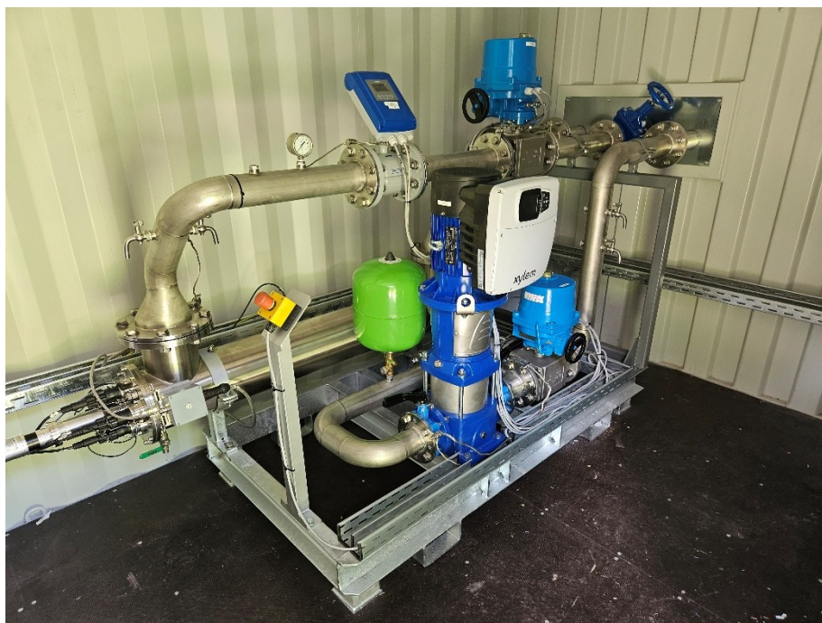
Abbildung 4: UV-Desinfektionsanlage LBX90e in Seecontainer.
