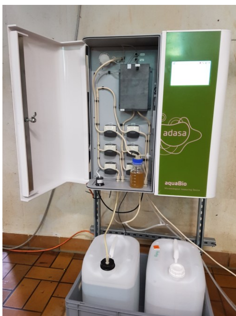
Abbildung 8: Schnellmessgerät für E. coli im Keller des Filtrationsgebäudes. In der Flasche befindet sich das Nährmedium; in den Kanistern eine saure Desinfektionslösung.
