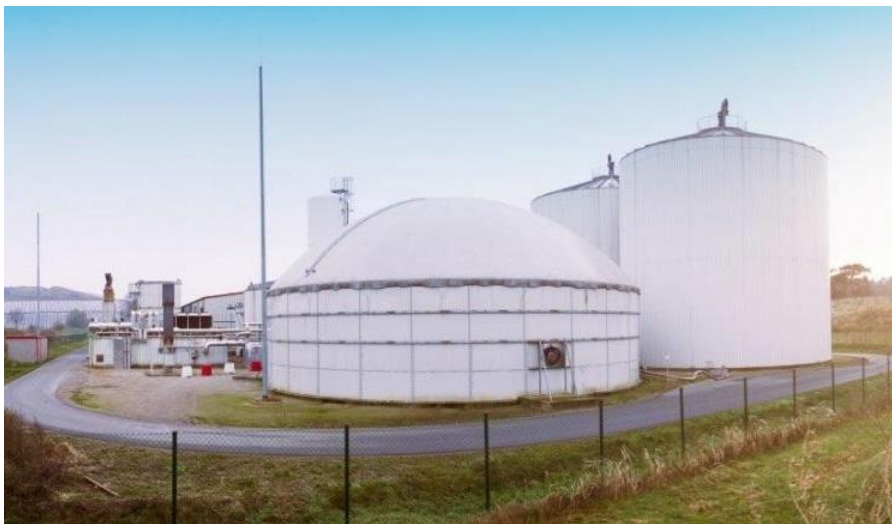
Abbildung 20: Biogasanlage Bardowick (Quelle: Veolia Deutschland)
