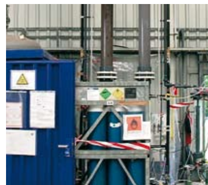
Pilotanlage am Standort Klärwerk Ruhleben Pilot Plant at WWTP Ruhleben
